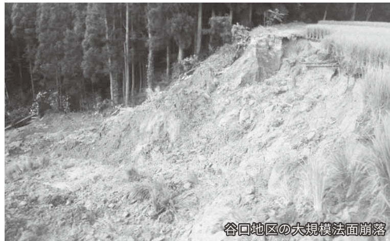
松の木橋上流の道路浸食
