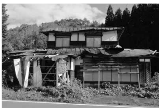
平成30年度に行政代執行を行った危険空き家
