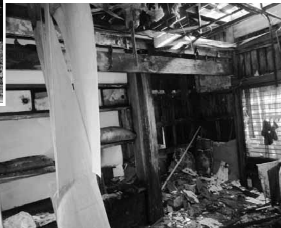
危険空き家の内部
