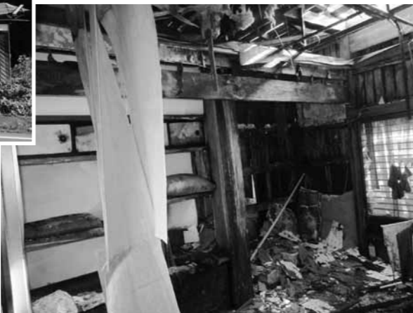
危険空き家の内部
