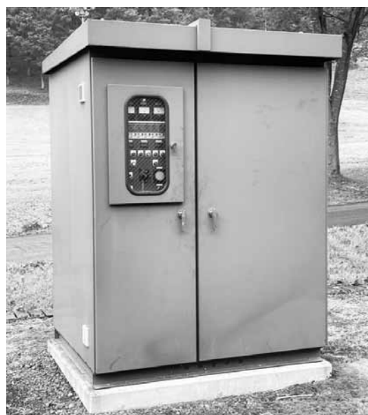
大清水源泉ポンプ操作盤
