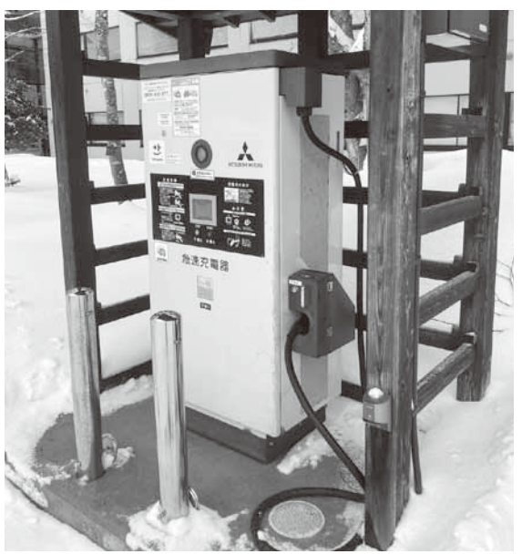
無償譲渡を予定している電気自動車急速充電器
