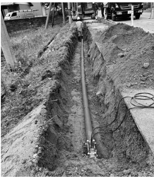
老朽化が進む水道管
