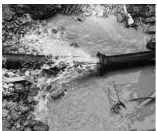
破損した水道管
