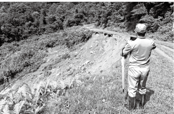
神室スキー場迂回コースの大規模な土砂崩れ
