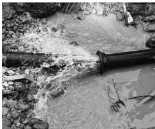
破損した水道管
