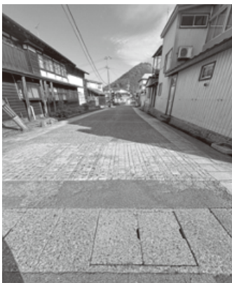
傷みが激しい半たわみ性舗装
