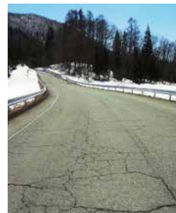
除雪作業による道路の傷み
